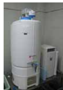
改善後(純水製造装置1台)
